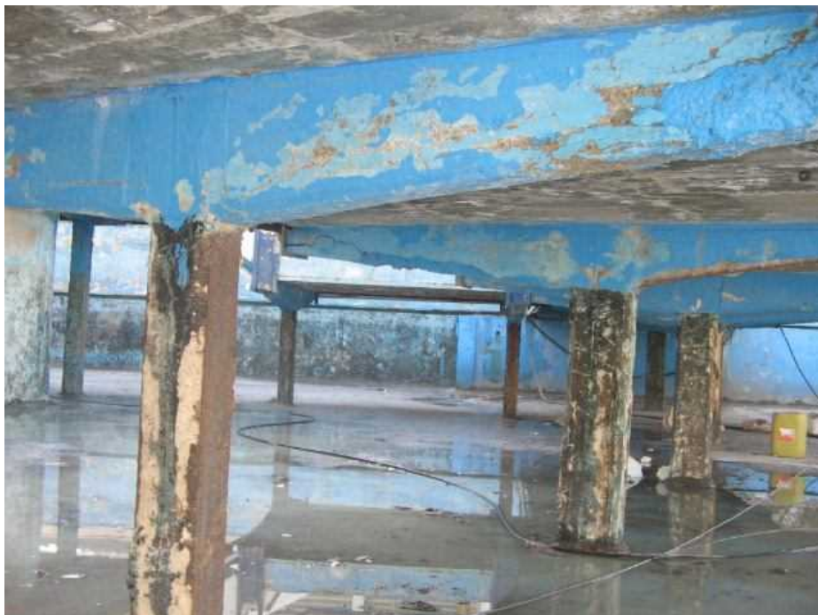
نمایی از ستون‌های داخل آب‌نما که به شدت دچار آسیب به علت نداشتن عایق مناسب شده است
